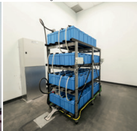
Beispiel mit 16 Batt-Packs, Gesamtleistung: 116kWh
