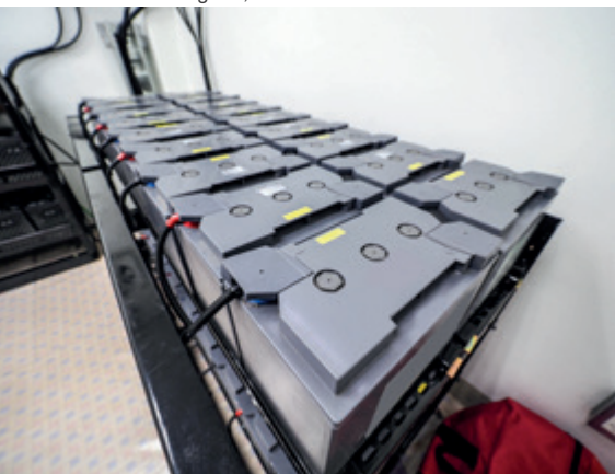
Beispiel mit 4 Batt-Packs, Gesamtleistung: 28,8kWh
