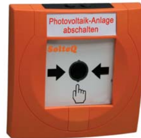
Not-Handmelder, gleichzeitig Zentrale
